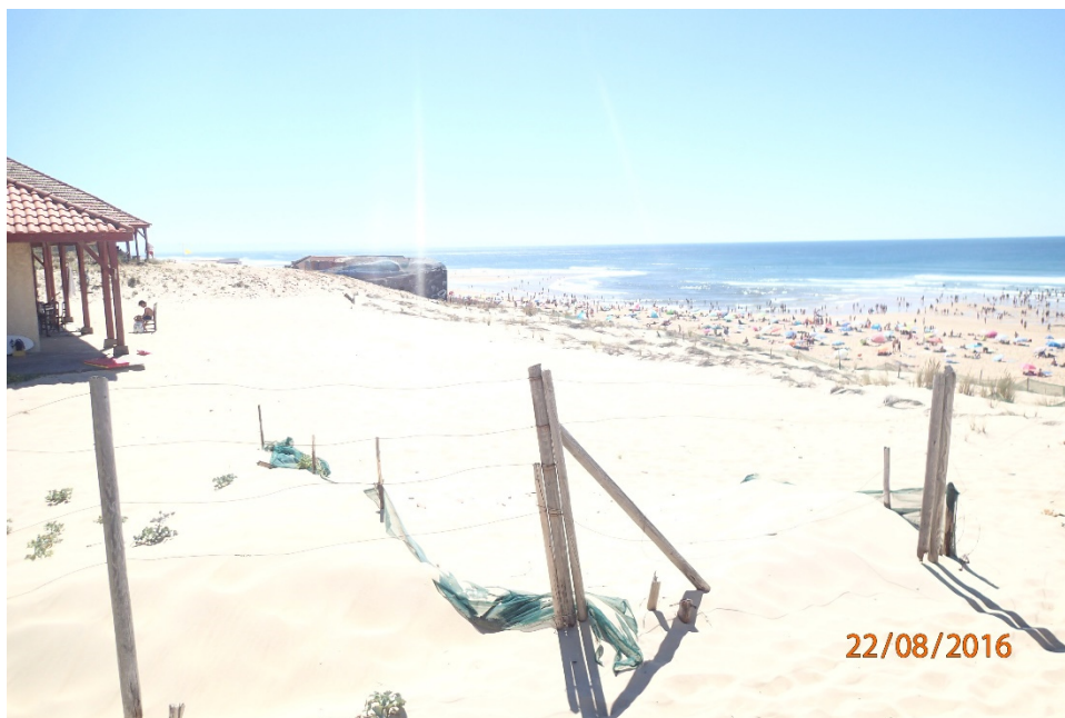
Clôtures fils lisses en mauvais état
